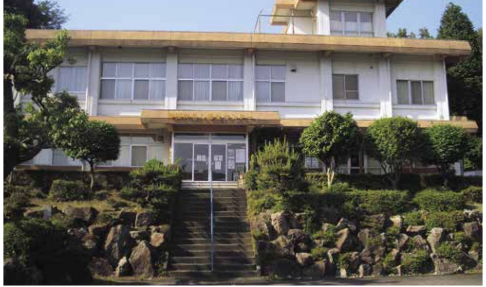
老朽化が進む公共施設（老人福祉センター）
