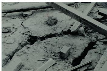
地割れの様子
