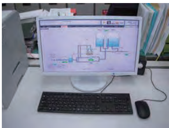
中央監視装置
