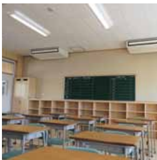
増築校舎のエアコン
