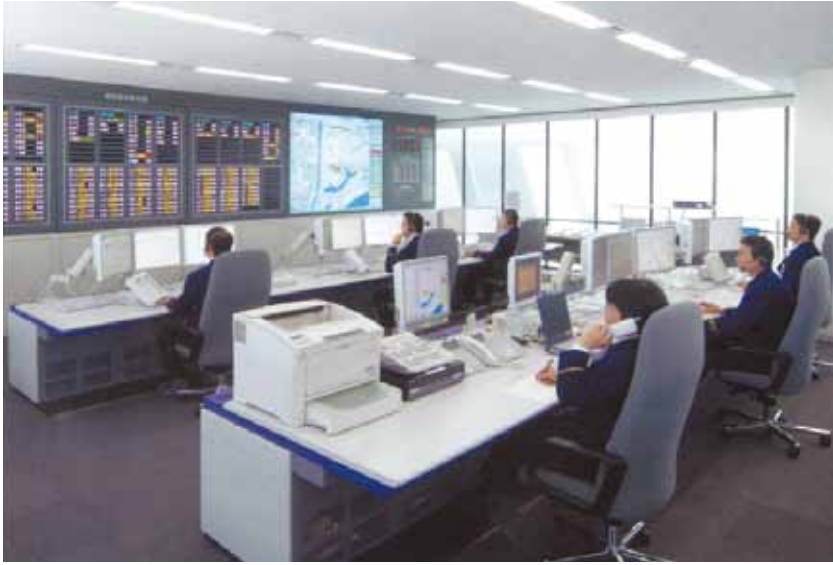
消防司令室（岡崎市）
