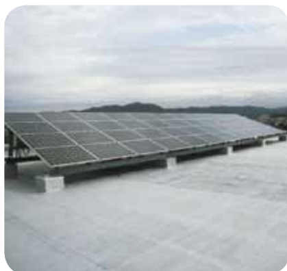
太陽光発電設備 幸田・南部中学校（避難所） 5831 万円
