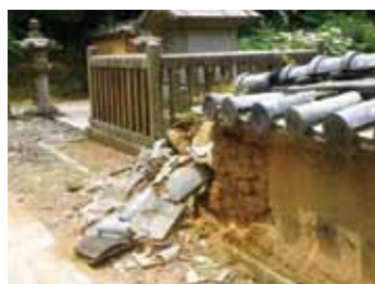
地震による崩壊か
