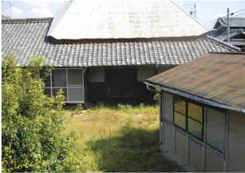
放置された空き家
