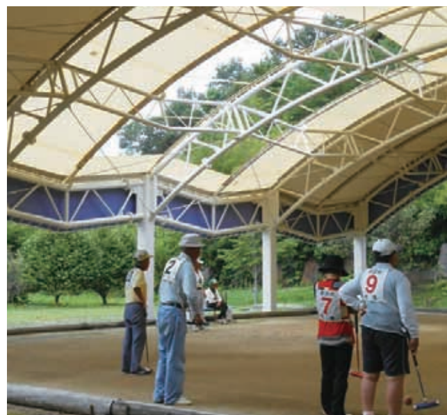
破損した上屋テント
