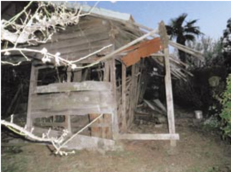
放置された空き家
