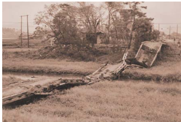
崩壊した観音橋（岩堀地内）
