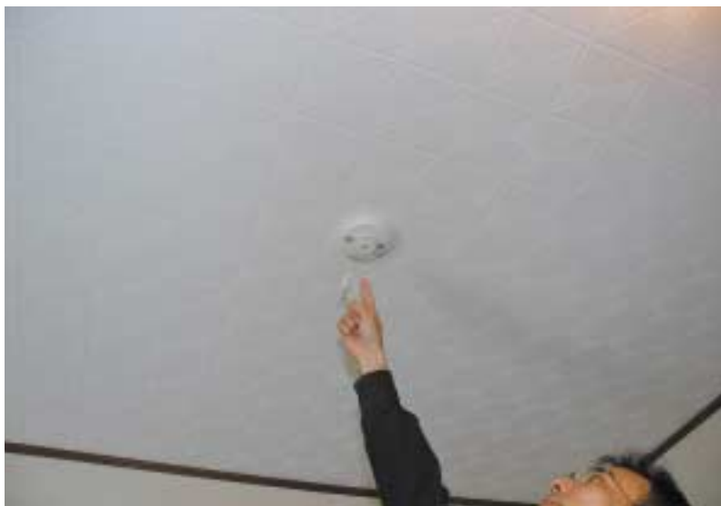
取り付けられた家庭用火災警報器
