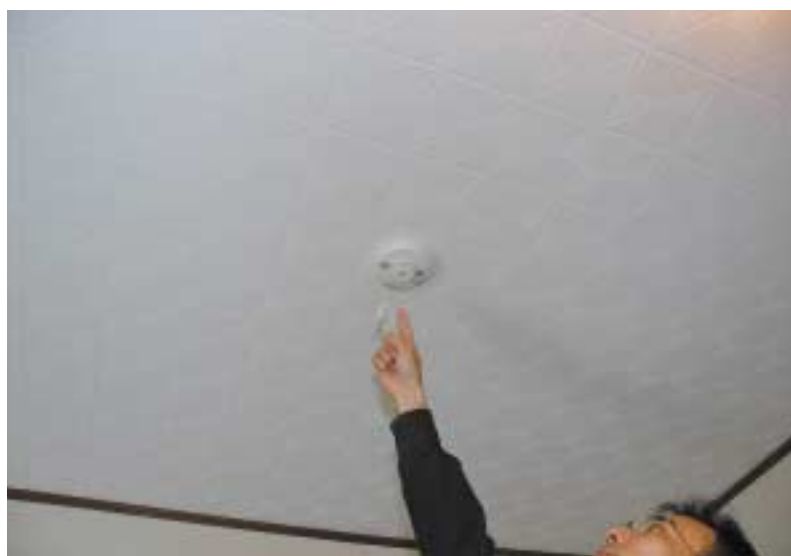
取り付けられた家庭用火災警報器
