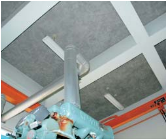
アスベスト含有が心配される排水機場の天井
