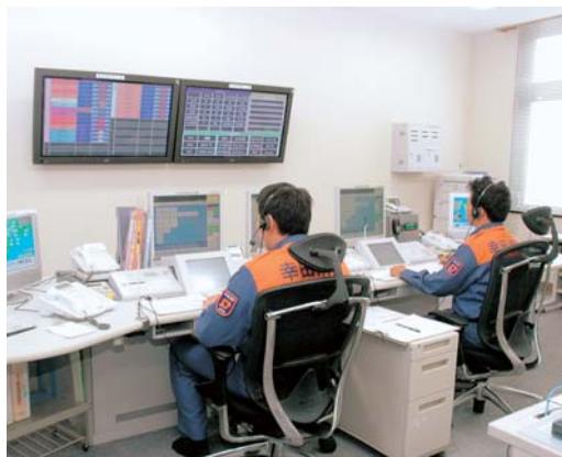
消防署通信室で常時監視
