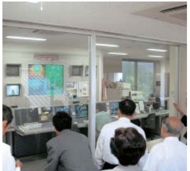
焼却炉の集中管理室
