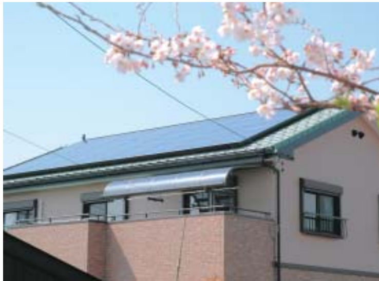
太陽光発電システム設置の住宅
