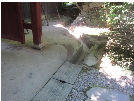
山門一帯 排水路に接続する管路断面が狭いため、大雨で山門一帯が浸水する。
