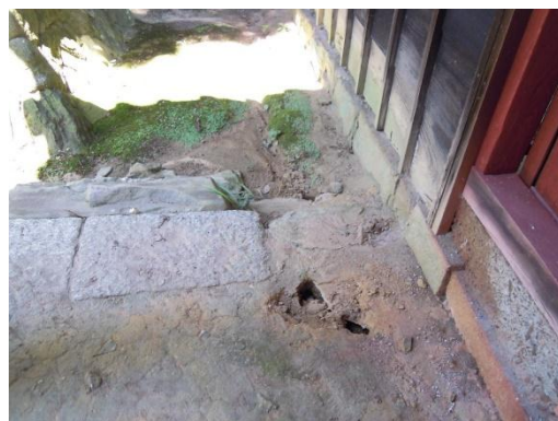
浸食によってできた山門西側の水抜け穴門東側の三和土の穴から水が入り、山門の基礎地盤を通過し、西側の穴から噴出している。
