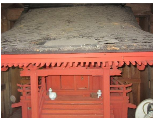
鎮守堂 柿板が剥がれている。
