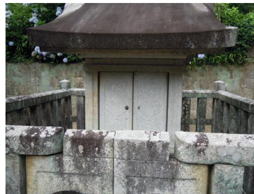
6 代忠房墓 石殿扉金具の欠損
