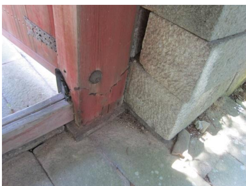
東廟所門 傷んだ門柱に設置されていた根巻きが取れている。
