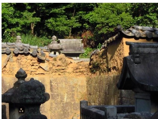
三河地震で崩落した築地（廟所上段南側、花壇から）。漆喰・中塗りが落ち、団子状の茶色土の積み重ねられた状態が露出している。
