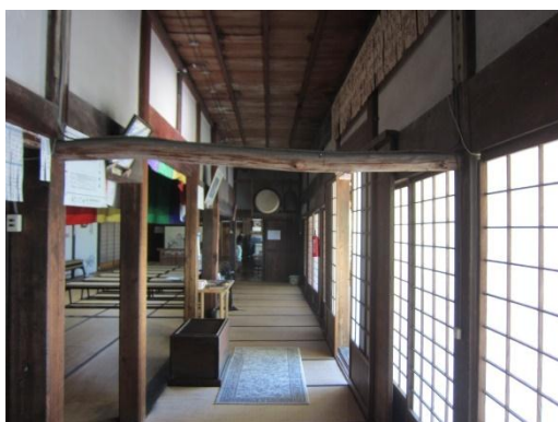
本堂 西側畳廊下の柱間に丸太材でつかい棒がされている。
