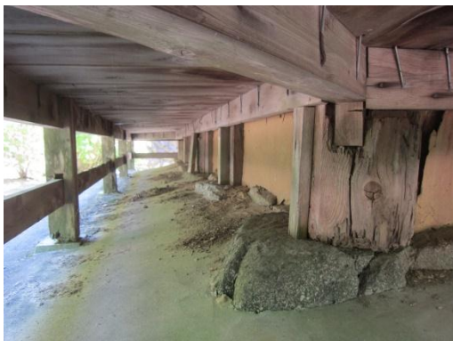
肖影堂 床下の柱と床板に添え木がされている。
