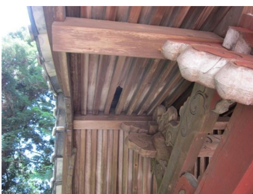
東廟所門 軒裏に小動物が出入りする隙間がある。
