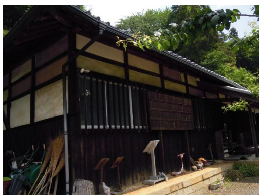
位牌堂 外壁の漆喰が剥がれ落ちている。
