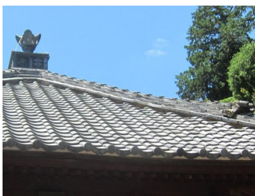
肖影堂 H21 台風で瓦が落下し、宝珠は新設したが、鬼瓦は破損したものを載せ直した。
