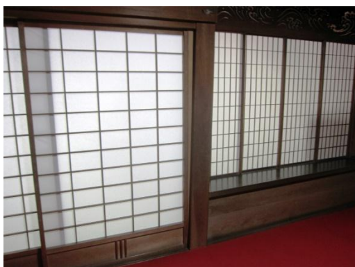
本堂 奥書院の柱が傾斜し、建具との間が最大5cm程あいている。
