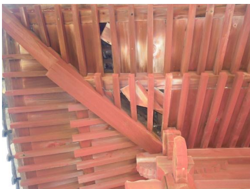
肖影堂 軒裏に小動物が出入りする隙間がある。
