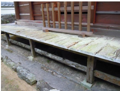
肖影堂 縁側の東が東石の芯からずれている。貫が風化している。
