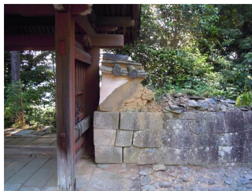
東廟所門の屋根の下の築地は、雨水が直接当たらないため、瓦や漆喰仕上塗が残っている。一方、屋根の外では築地自体が崩落している。
