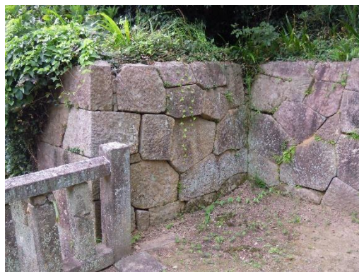
東廟所上段北側の石垣 緩み孕みが確認できる。
