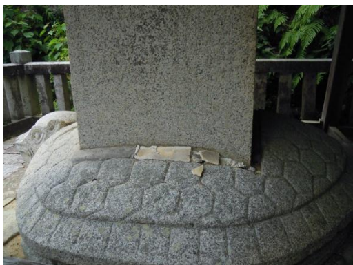
祖宗紀功碑（亀趺碑） 碑身と台座の間詰めコンクリートが破損している。
