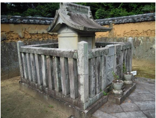
13 代忠侯墓 玉垣の柱の破損、貫の欠損
