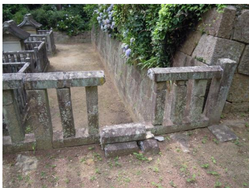
東廟所上段北側の玉垣の破損。転落の危険性あり。
