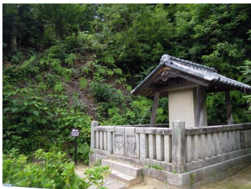
西廟所祖宗紀功碑裏の斜面 急傾斜の法面で H24 年に崩落した土が現在も残る。
