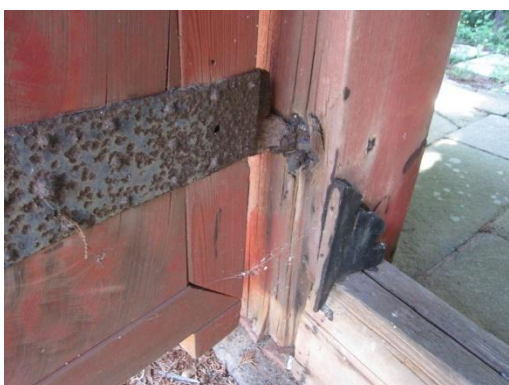
東廟所門 扉金具が傷み、門扉が傾いている。
