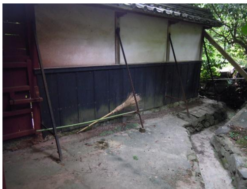
山門 大雨で浸水し、地盤が弱体化している。袖壁は転倒防止の支柱を設置している。
