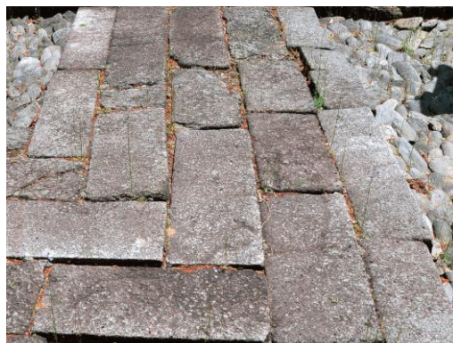
9代忠刻墓前の参道 地震により路面が凹凸し、敷石もずれている。修理をしていない状態である。
