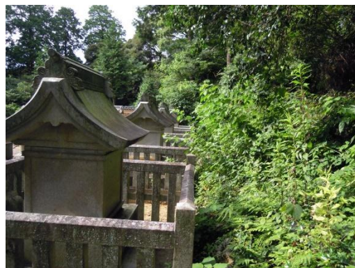
東廟所南東部裏の斜面 H20 年 8 月末豪雨で背後の斜面で土砂崩れが起こり、石垣が崩落した。
