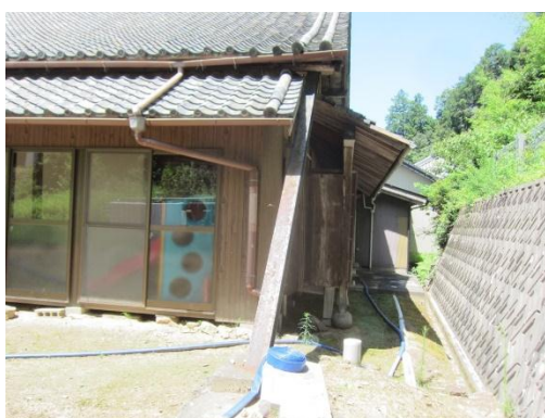
本堂 北東部で軒桁を鉄骨で補強している。斜面沿いに側溝、管路が敷設されている。
