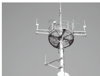
▲基地局アンテナ
