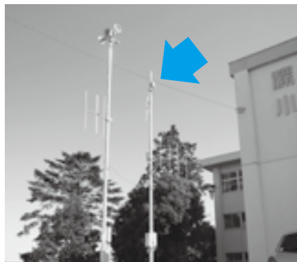
深溝小学校に設置された簡易中継局
