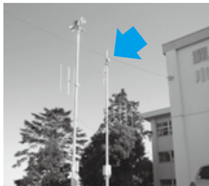
深溝小学校に設置された簡易中継局
