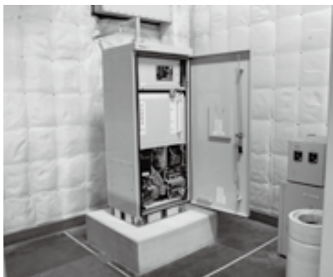
防災無線専用の自家発電装置
