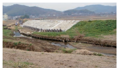
◀破堤地点の現在状況
