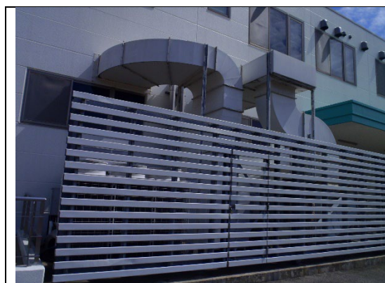
地上室外機の囲い
