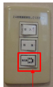
全熱交換機のスイッチの例
