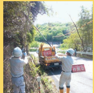
④町道路に倒れ込んだ竹木の伐採
