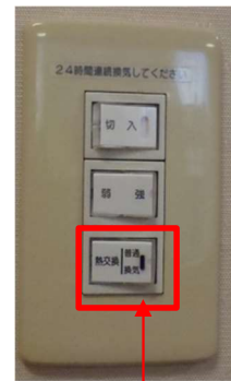
全熱交換機のスイッチの例
