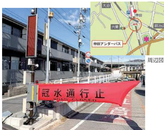
エア遮断機（仲田アンダーパス西側）
