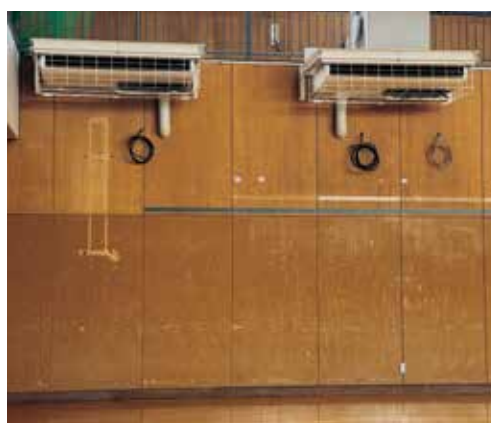
エアコン設置された中学校体育館
