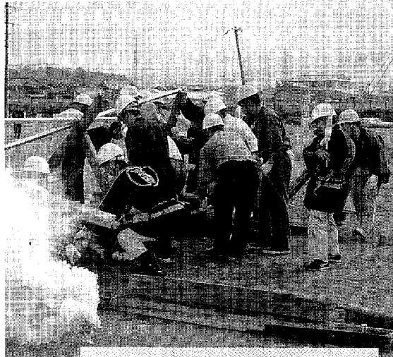
倒壊した建物での救助は人手がたより
