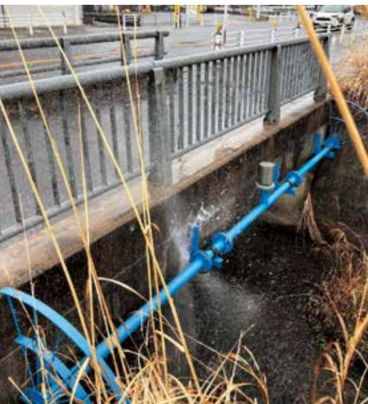
漏水した水管橋（芦谷区）
