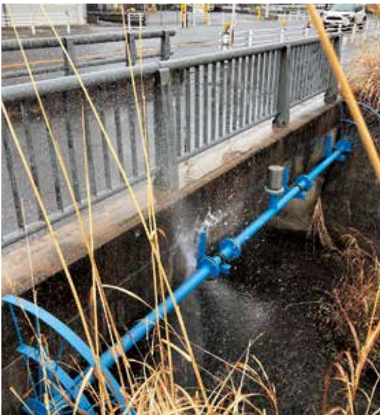
漏水した水管橋（芦谷区）
