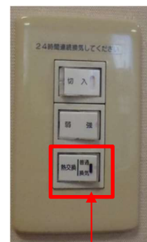
全熱交換機のスイッチの例
