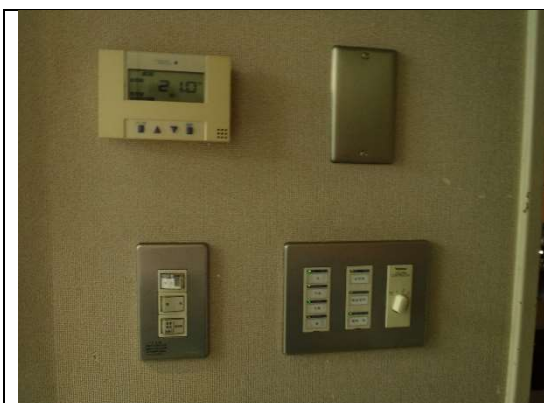
空調の目安、熱交換器の使い方が示されていない
