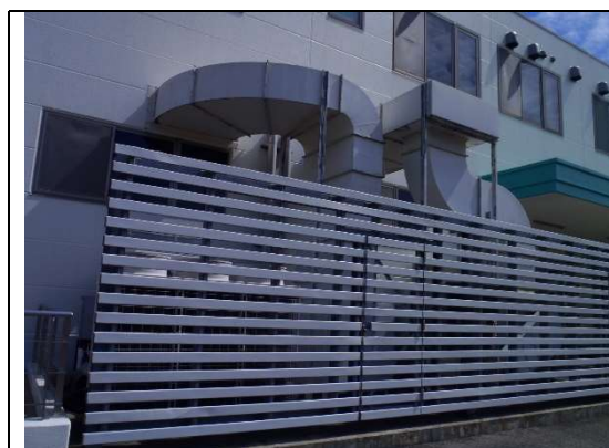
地上室外機の囲い
