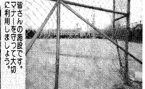
壊れたフェンス
