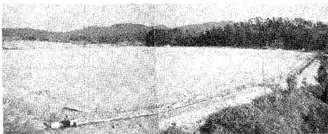
▲(坂崎)町民グラウンド 建設される 坂崎小学校東側で町民運動場(面積一七、二三三㎡・工事費六二十万円)の整備が八月十二日から行なわれていたが今月中旬に完成します。
