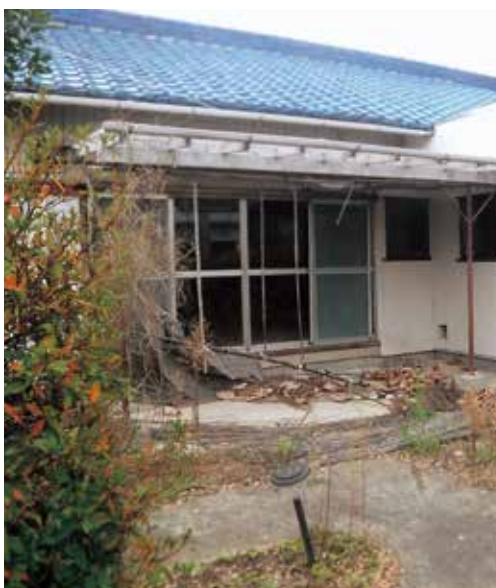
放置された空き家
