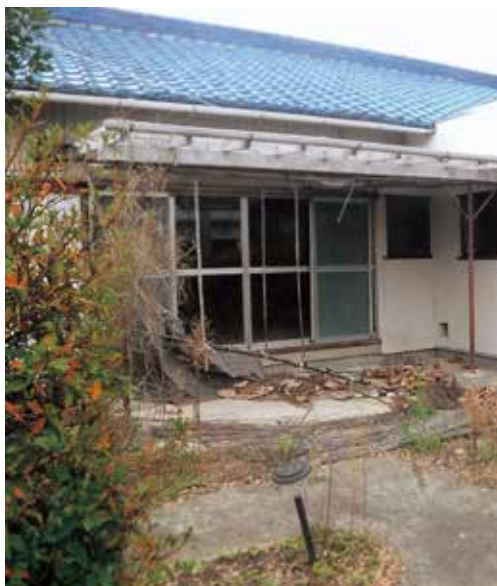
放置された空き家
