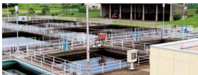
県営幸田浄水場
