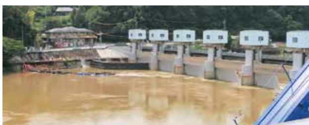
明治用水頭首工漏水箇所
